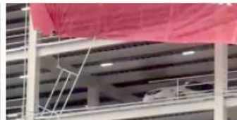
Una lona se enredó en la estructura de un estacionamiento en la calle Ocampo en el Centro.
